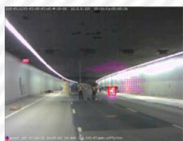
Détection réflexion de flammes (Tunnel de Montréal - Canada)
